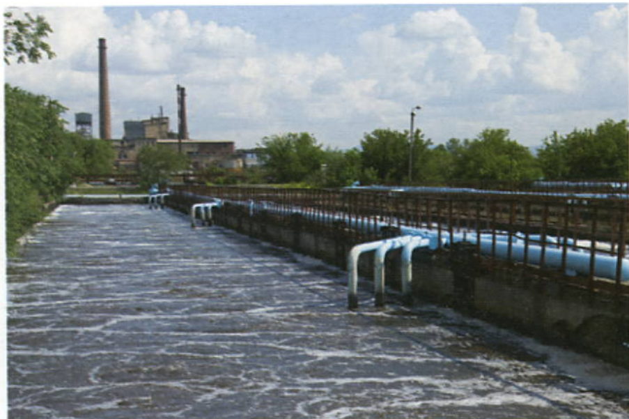
De beluchtingsreservoirs van de afvalzuivering.
